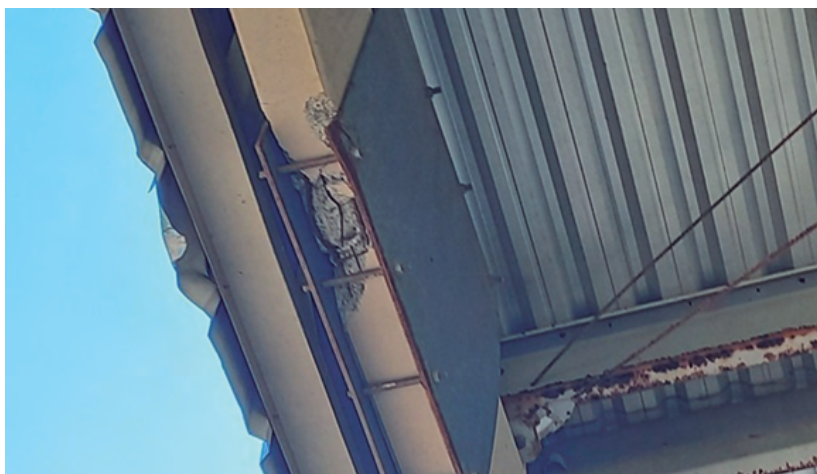
Figura 5 - Colapso de viga devido solicitação lateral de uma linha de vida horizontal. Fonte: Acervo do autor
