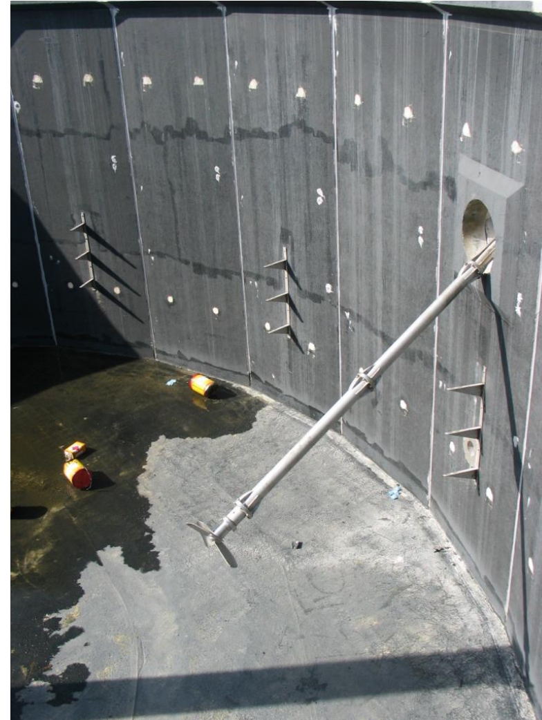
Detalhe de equipamento – interior
