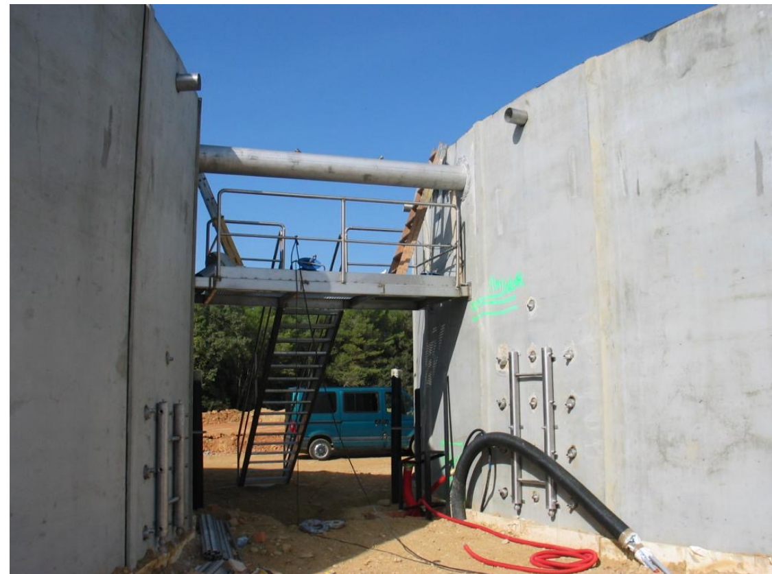
Detalhe de interligação entre tanques
