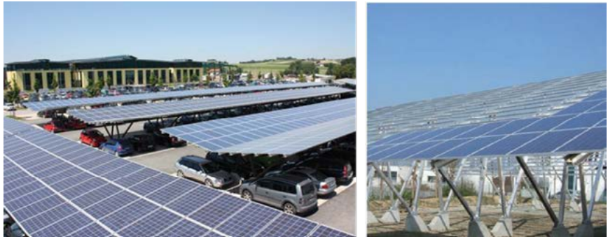
Figura 26 –Estructura tipo CarPort / Fuente: Google imágenes
