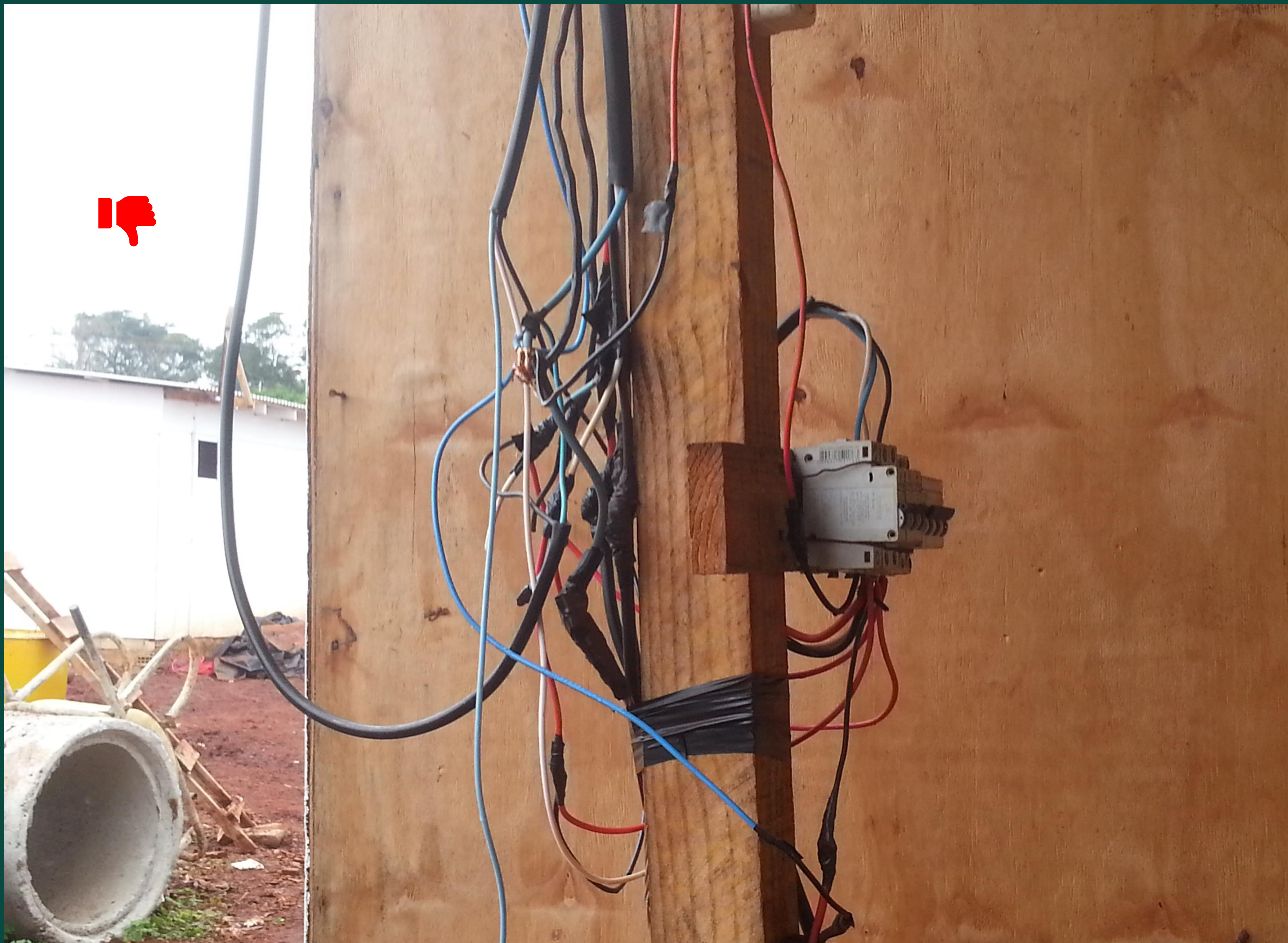
Fiação sem dupla proteção, com muitas emendas e componentes desprotegidos
