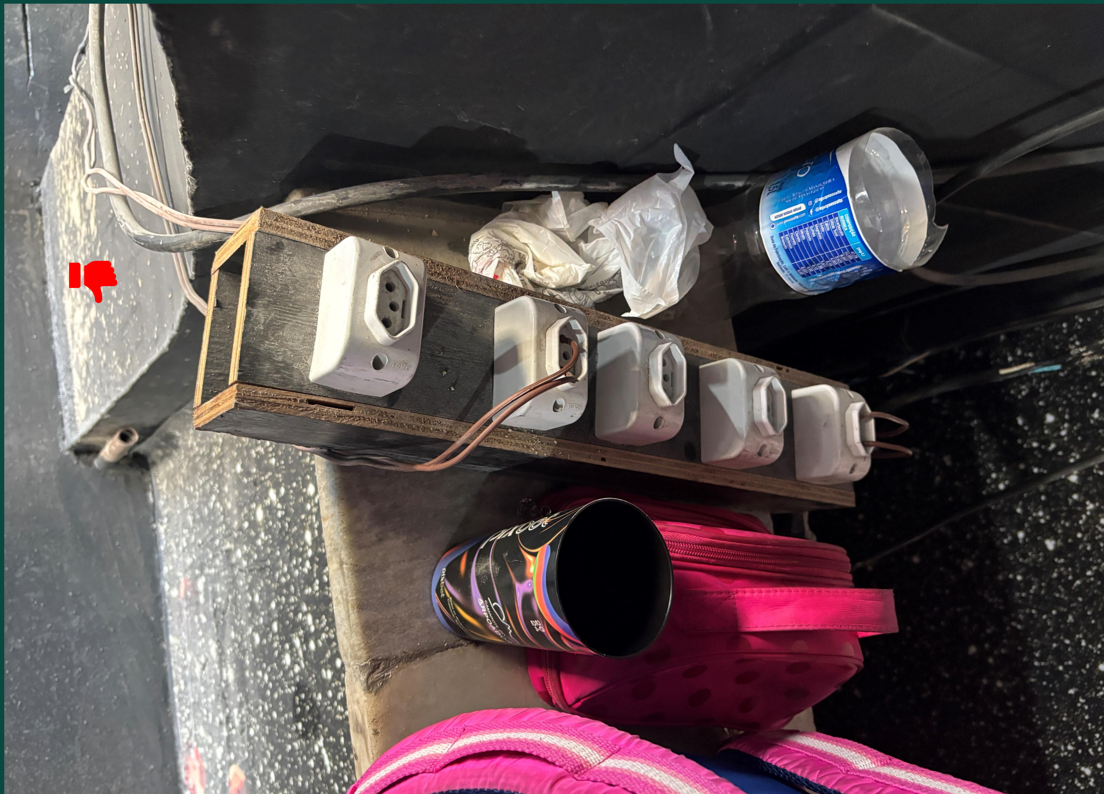
Réguas improvisadas ou residenciais para distribuição da energia
