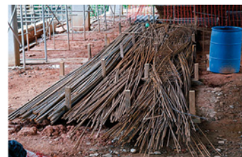
Foto 03 - Depósito de vergalhões (falta de espaçadores e organização)
