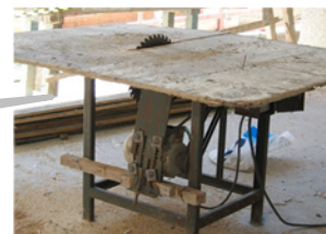
Foto 01 - Mesa de serra circular de bancada sem proteção
