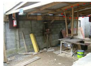
Foto 02 - Iluminação irregular na carpintaria
